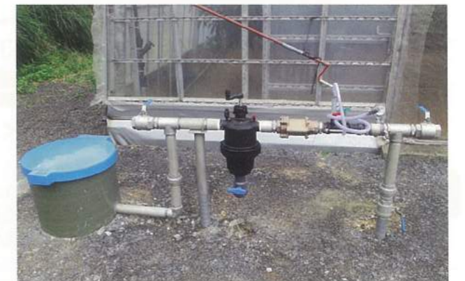
給水口(フィルター・減圧弁・混入器)
